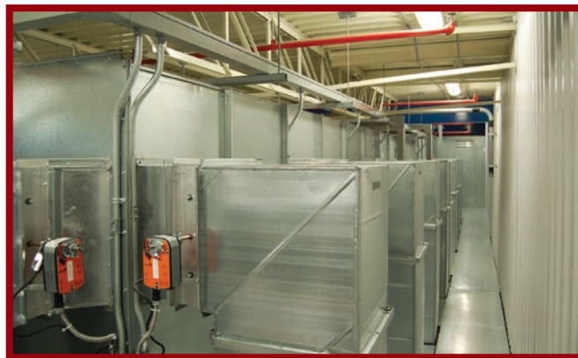
Drying air supply plenum.
