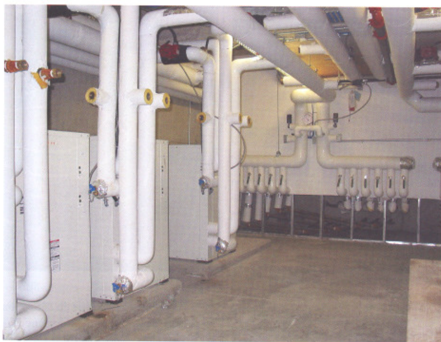
Thermopompes géothermiques reliées aux puits.
